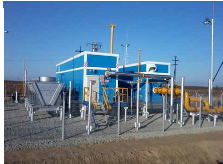
Компрессорная станция производительность 26000м 3 /час
